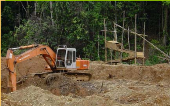
Pelle mécanique et sluice (rampe de lavage avec tapis-brosses)
